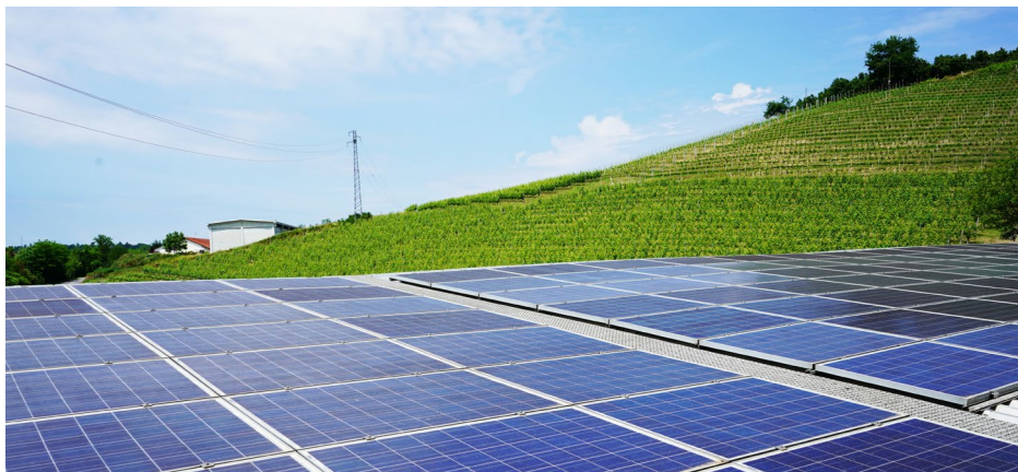
9000 Quadratmeter Solarzellen auf dem Fabrikdach produzieren sauberen Strom.
