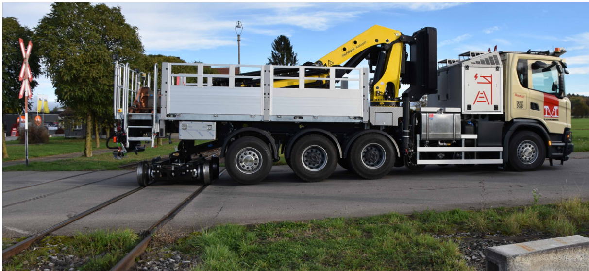
Vorbereitung, um den nächsten Einsatz auf dem Schienennetz erledigen zu können. Wenn das 2-Wege-System einmal abgesetzt ist, kann das Fahrgestell des Lastwagens angehoben werden und durch das 90° abdrehen auch der zweite Teil auf das Schienennetz gestellt werden.
